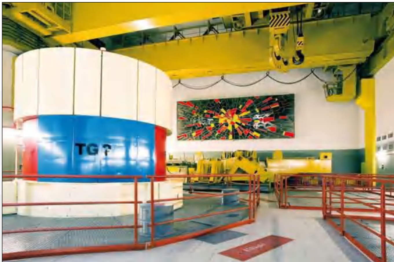
Technické zázemí elektrárny Dlouhé stráně - kaverna generátoru
