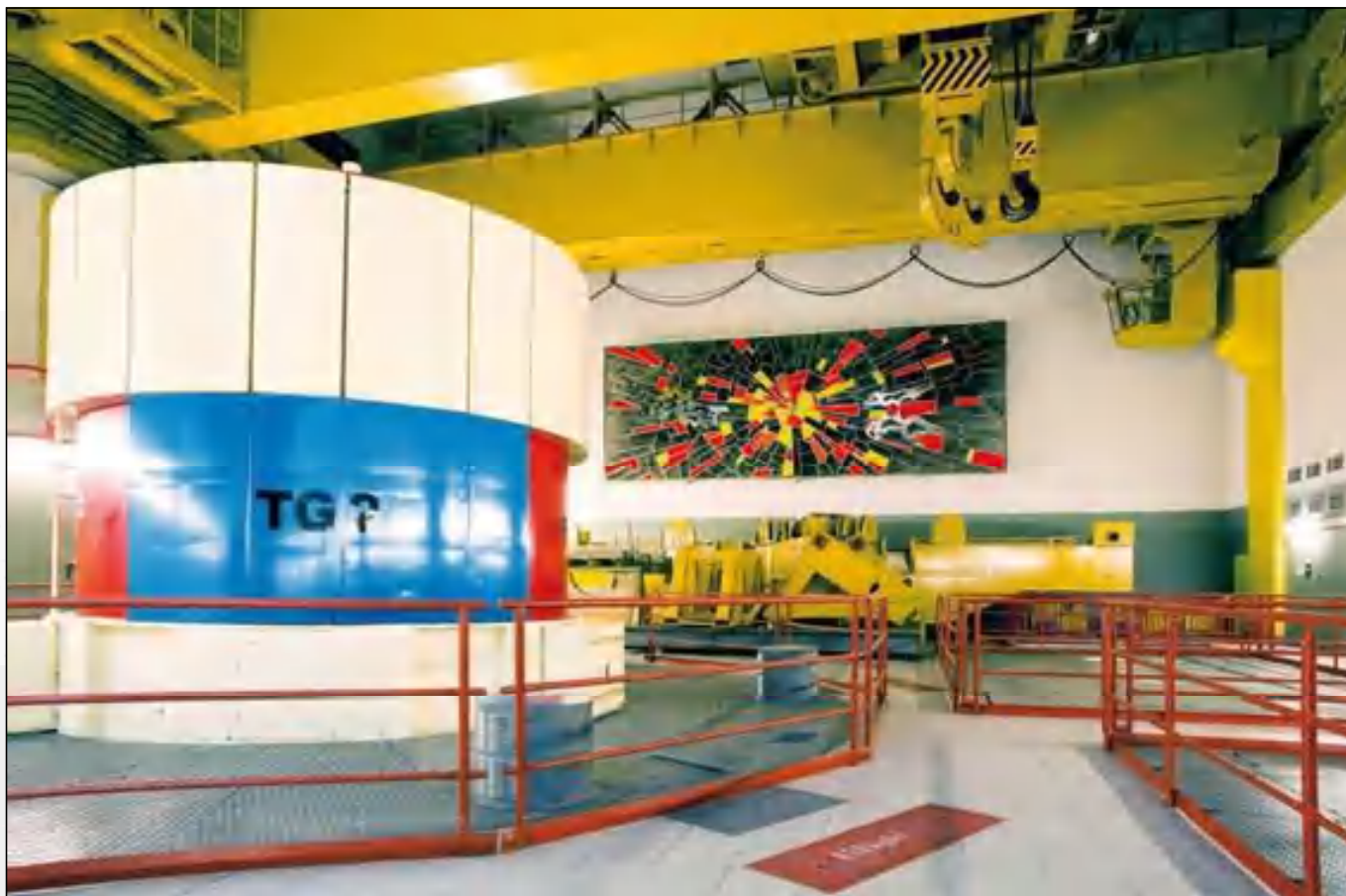
Zaplecze techniczne elektrowni Dlouhé stráně – kawerna generatorów
